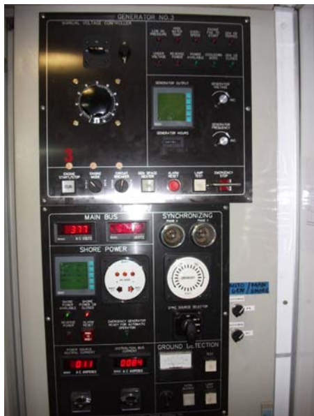
Exterior del cuadro de control de uno de los grupos y de la toma de puerto existentes
